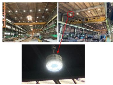
<事例2> 橋梁製作工場内のLED照明の採用
