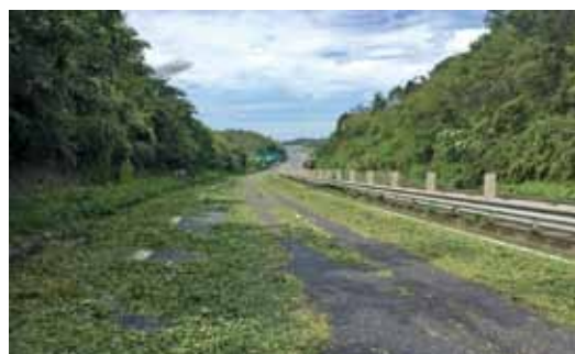
路面を覆いつくすように散乱した枝葉(館山道)
