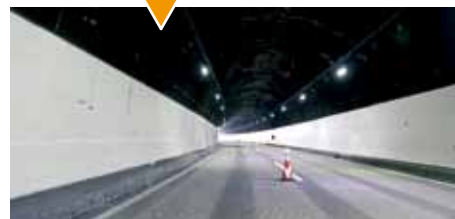
LEDトンネル照明
