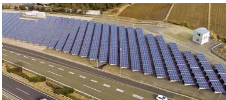
仙台北太陽光発電所
