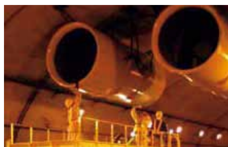
▲ トンネル換気設備の点検
