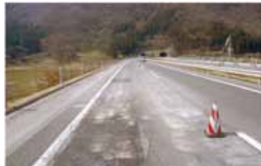
▲基層以深劣化状況
