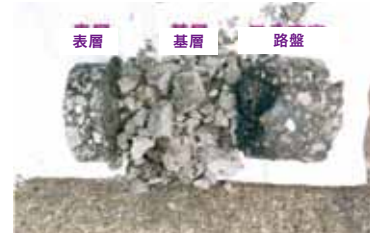
▲基層劣化箇所の採取コア
